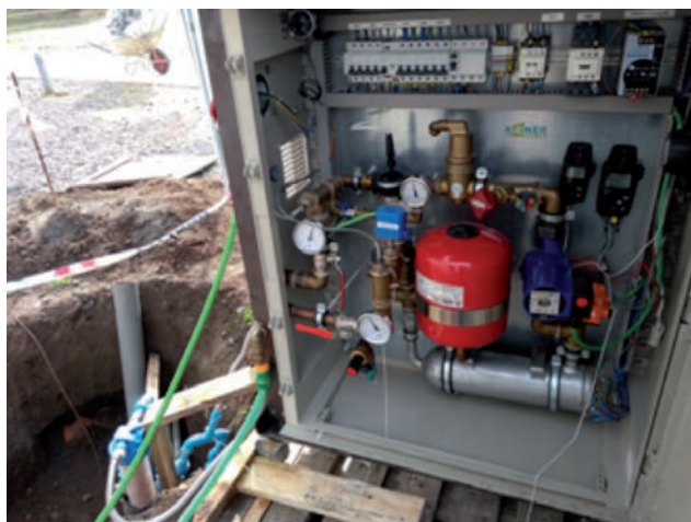
Figura 2: Sistema de test de respuesta térmica (TRT).
