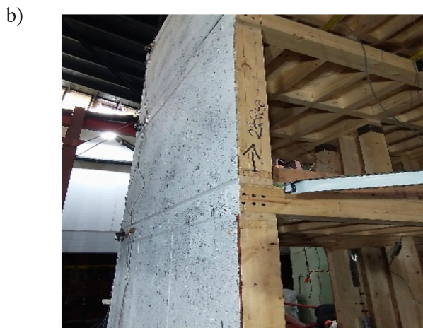
Figura 8: a) SDR y b) inspección visual del daño luego del ensayo
