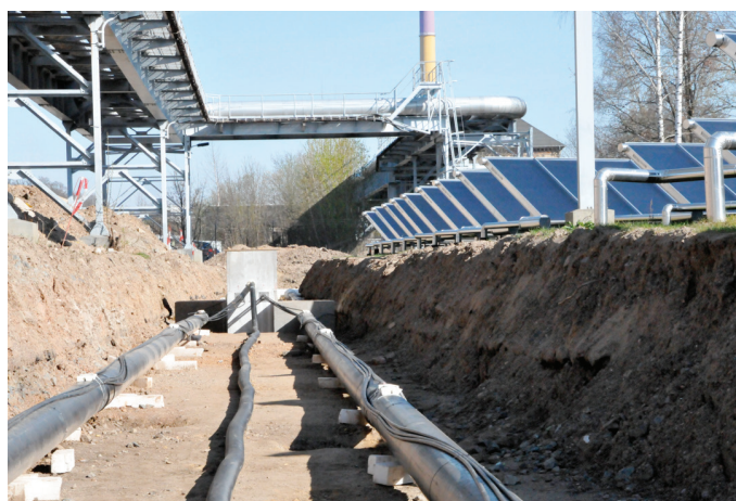
Figura 4: Vista de la zanja abierta con dos tuberías de calefacción distrital a los costados que llegan a los bloques de hormigón y en el centro se muestra un tubo con los cables de los instrumentos de medición de temperatura, presión del suelo y desplazamiento axial de las tuberías que luego fueron enterrados
