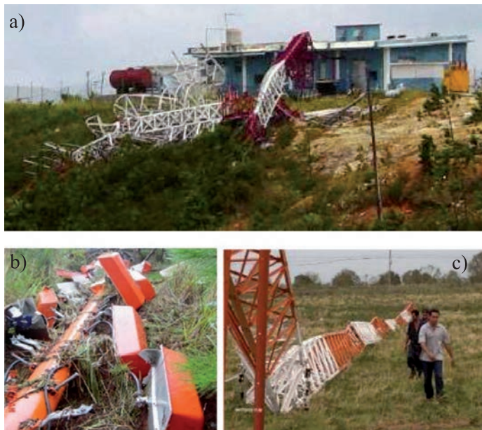
Figura 1: Fallo de torres de telecomunicaciones, Pinar del Río, Cuba: a) colapso total, b) presencia de antenas y c) fractura del fuste
