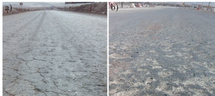
Figura 10: Fallas en el tramo estabilizado con: a) \text{CaCl}_2 y b) Bischofita
